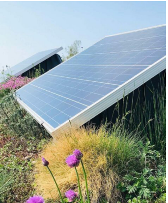
Solceller på sedumtak
