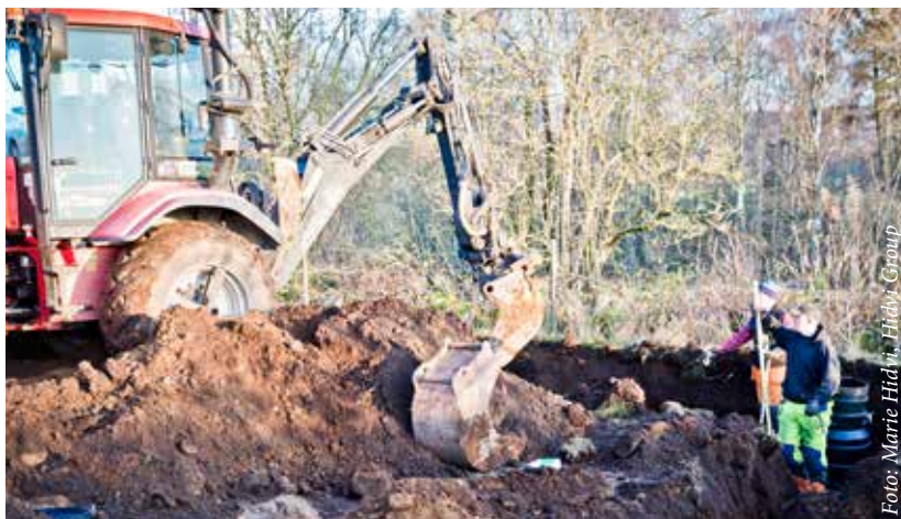
En infiltrationsbädd måste bytas hos Lars Erik Larsson.
