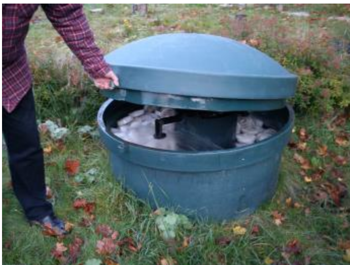
Bild 2 – platsbesök vid ett minireningsverk av fabrikatet Green Rock.
