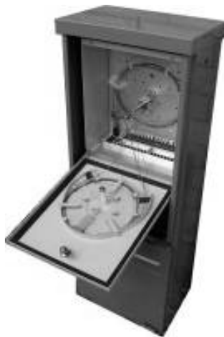
Figur: Exempel på Spridningspunkt (FOS) i teleskåp
