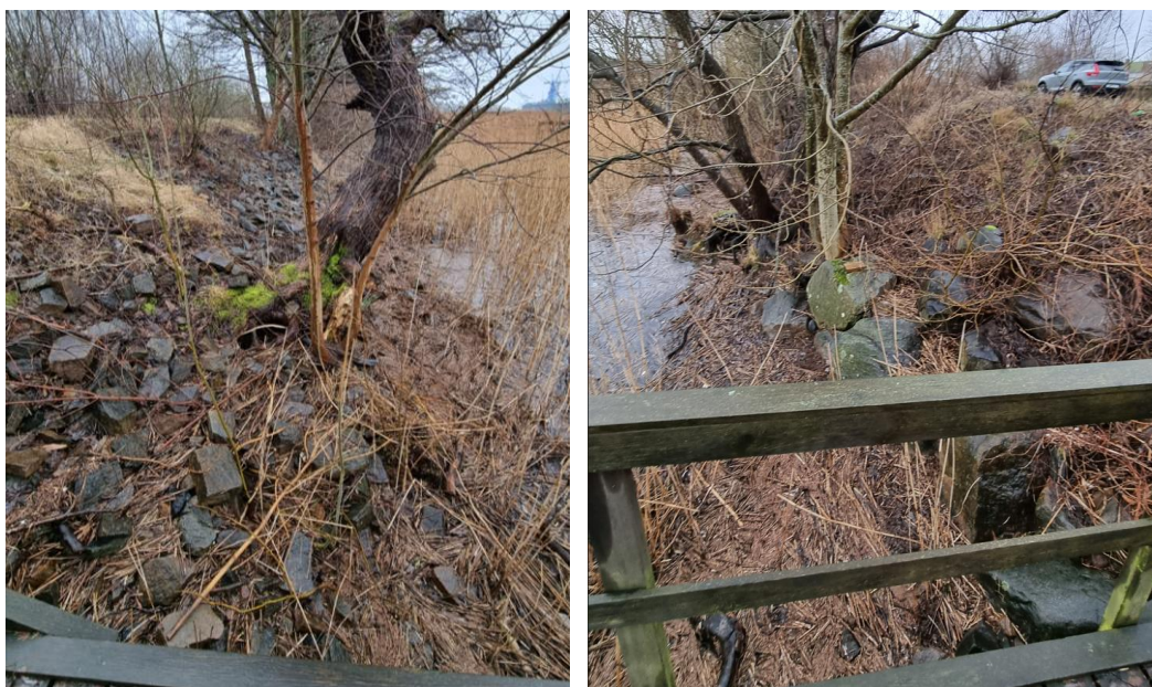
Figur 5.1. Slänt mot Ätran i södra änden av planområdet som delvis är erosionsskyddad.
