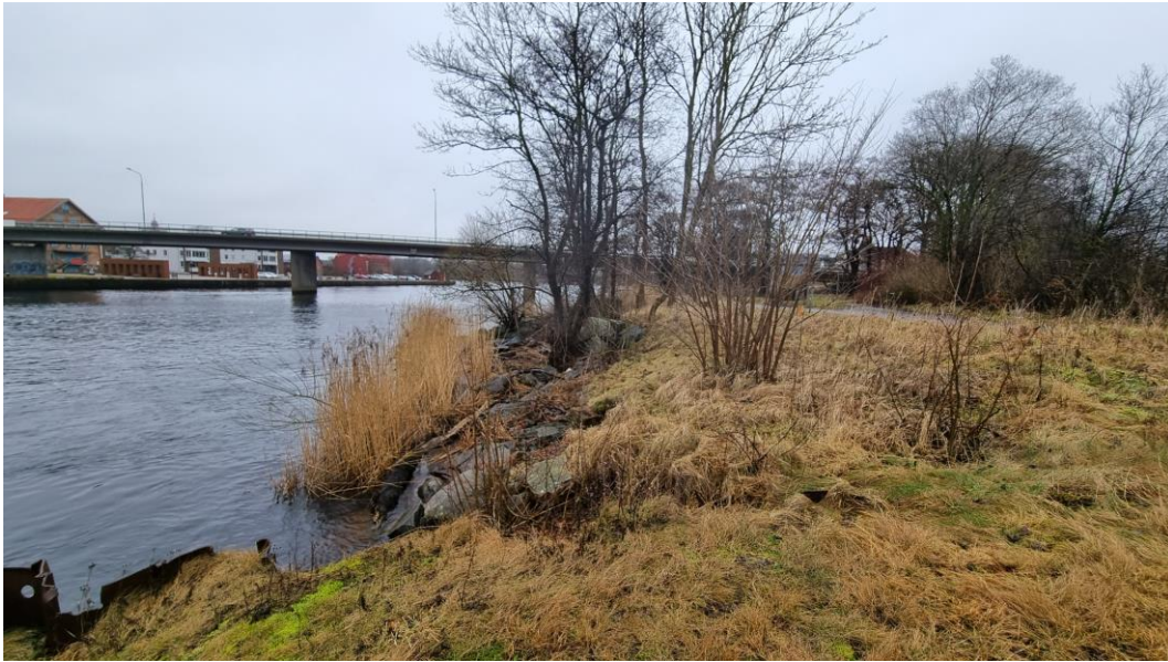
Figur 5.2. Område närmast norr om spontkajen som delvis är erosionsskyddad.
