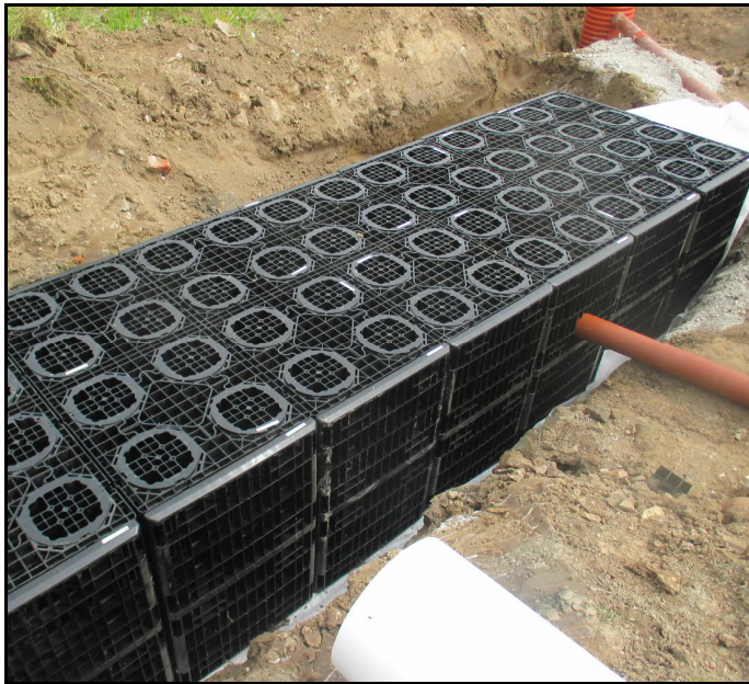
Foto 5. Dagvattenkassetter, inloppet kan ses till höger i fotot och utloppet i bakgrunden.
