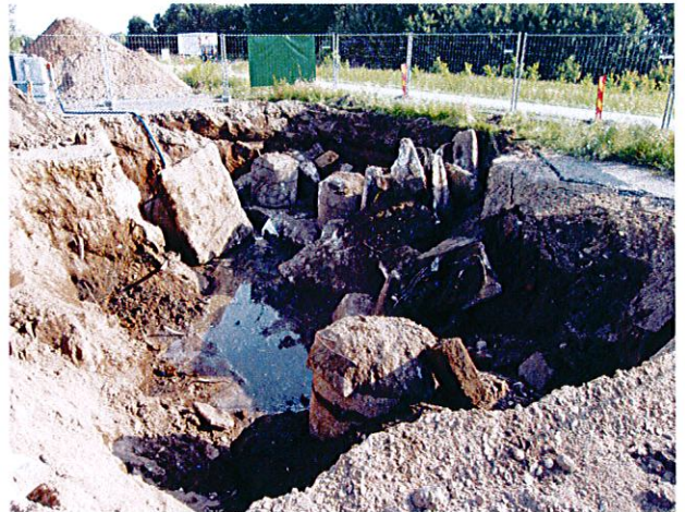
Bild 2. Ett flertal betongfundament hade lagts i schakten där cisternerna hade legat.
