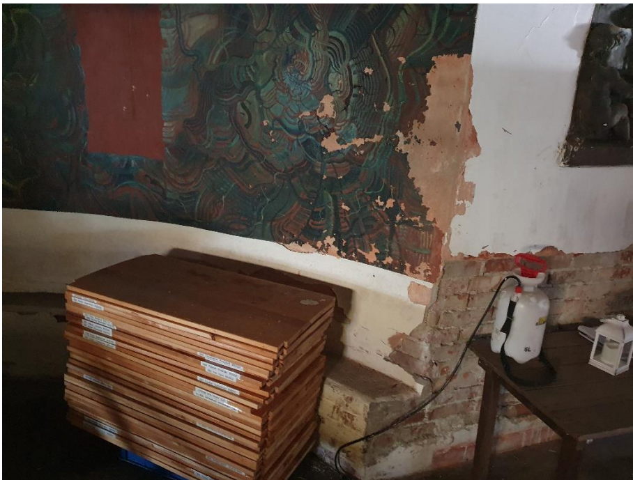
Figur 9. Vegg inuti kvarnen. Putsen har fallit av och blottar den äldre tegelväggen. Bildkälla: AFRY 2020-07-21.
