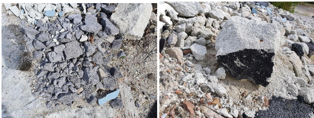
Figur 7. Krossad blåbetong till vänster, mistänkt fuktspärr till höger. Bildkälla: AFRY 2020-07-21.
