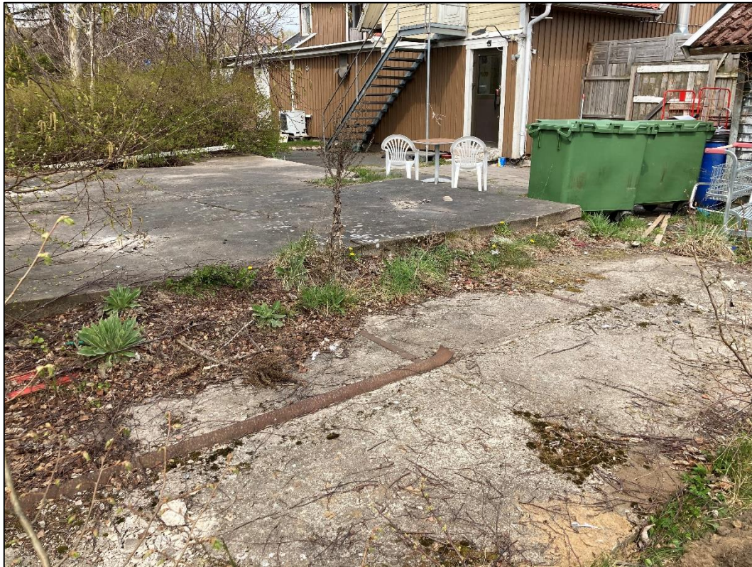
Figur 11. 21AF02_betong (längst bort), 21AF03_betong och 21AF04_betong (närmast).
