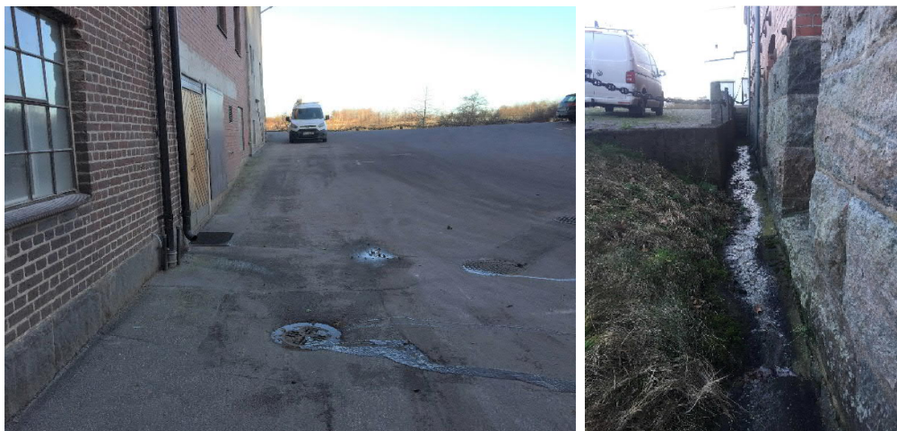
Figur 5. Dagvattenbrunn vid äldre byggnad i västra delen (delområde 1) . Till höger - Ytlig avledning från stuprör.
