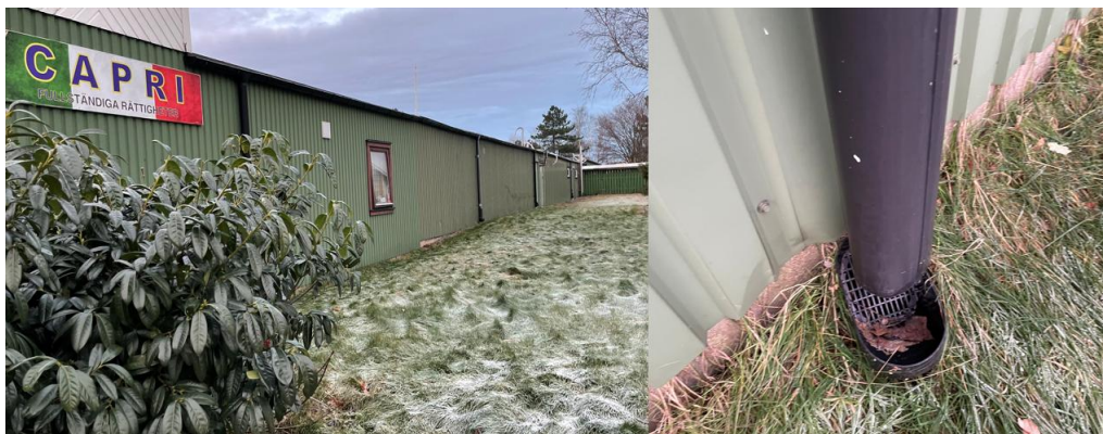
Figur 14 Takvatten från Elddonet 1 till dräneringsledningar
