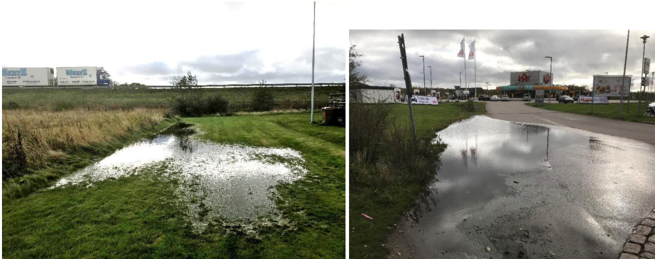
Figur 5 Befintliga ytor mot MAX med vattensamlingar 2019-10-14
