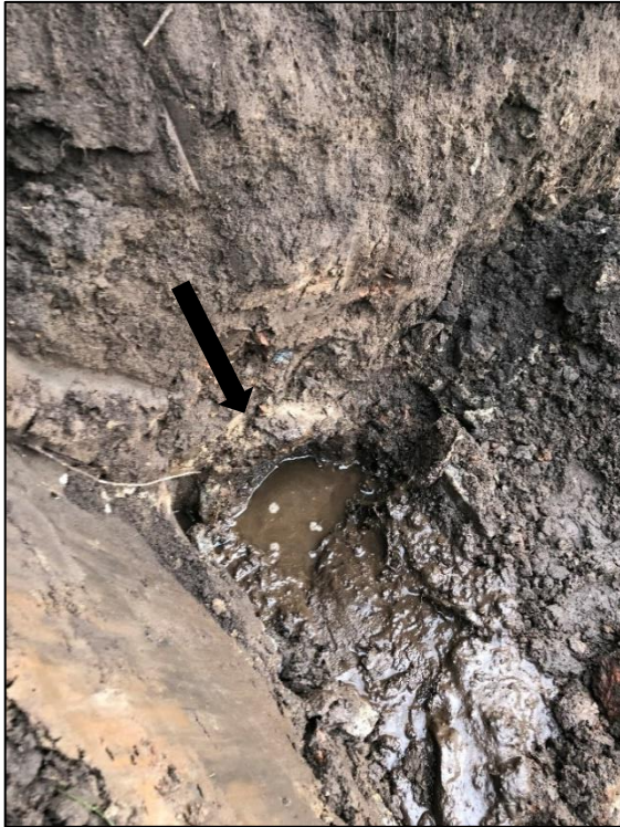
Figur 18. Del av ett betongrör som påträffades i provpunkt 21AF09. Foto: AFRY.
